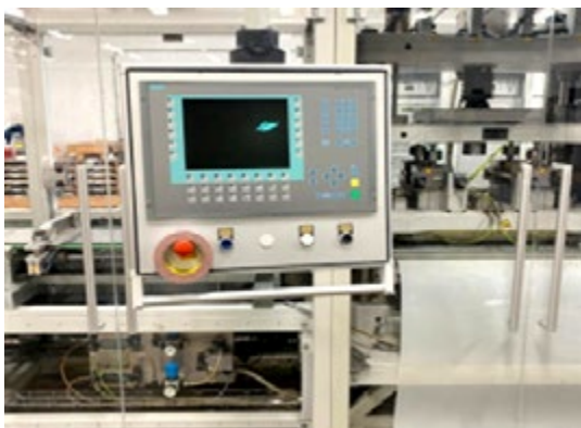
Figura 1. Tablero de control (de 9 PLC). Fotografía cortesía de Gabriel Rihan de SAMSILL de Mexico S.A de C.V.
